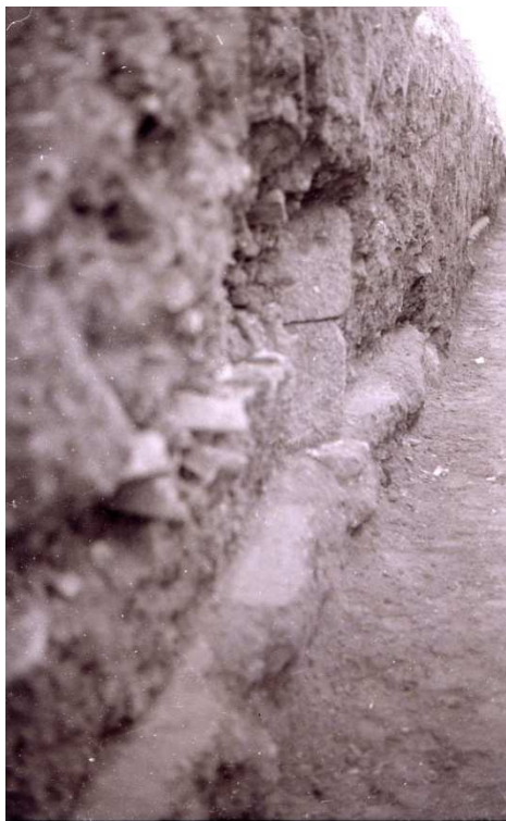
Figura 4.- Vista general de la zanja en su lado Norte, donde se observan las jambas elaboradas con sillares de piedra biocalcarenita (izqda.). En la imagen inferior, se observan las jambas del perfil de la zanja a la derecha totalmente excavadas y el resto de unidades murarias y pavimentales (imágenes cedidas por el autor).
